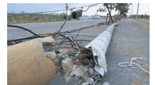
台風により倒壊した電柱
