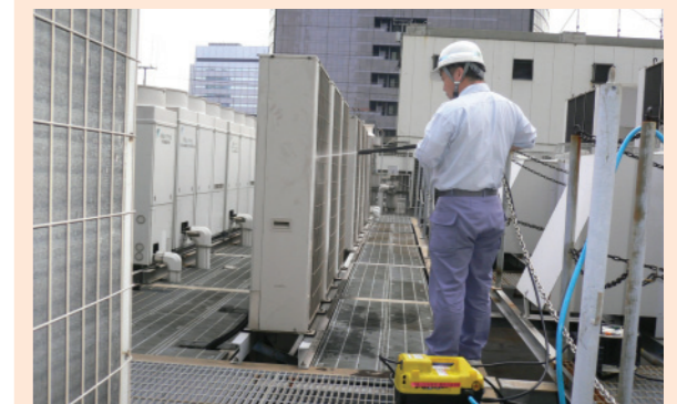
空調設備のフィルターを洗浄
