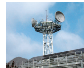
三重水ヶ平無線中継所
