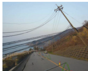
地すべりによる電柱の倒壊状況（輪島市打越町地内）
