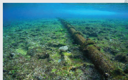
海底ケーブル 4800km
