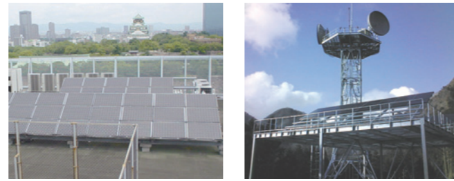
NTT西日本 馬場町ビル屋上のソーラーシステム 三重県水平無線中継所のソーラーシステム
