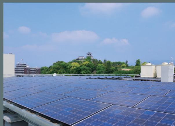
NTT高知支店ビル 屋上の太陽光発電システム
