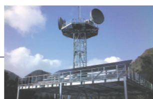
三重県水平無線中継所のソーラーシステム
