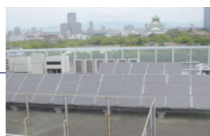
NTT西日本 馬場町ビル屋上のソーラーシステム
