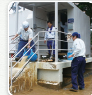
浸水した通信ビル
