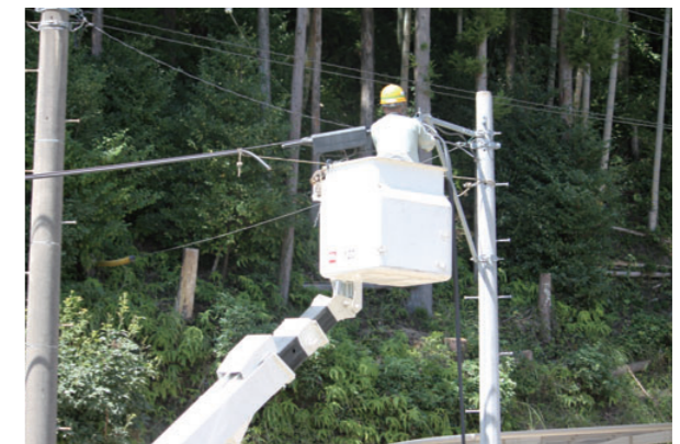
三重県：河川氾濫の増水が、5m程度の高さに到達したため、クロージャおよびケーブルの張り替えを実施。
