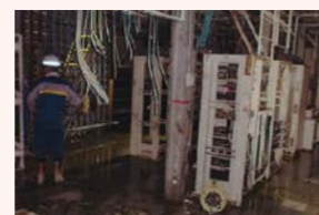
ラック上部まで浸水(真備ビル)
