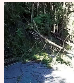
電信柱も倒壊
